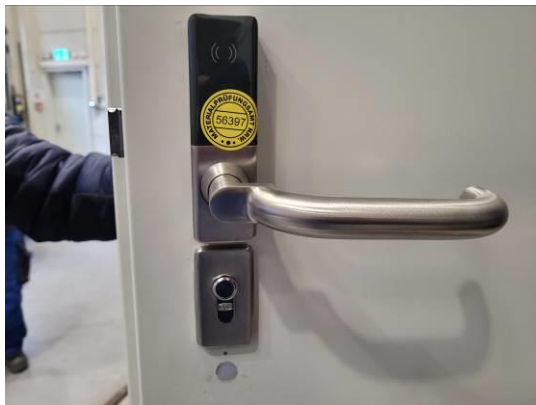
Bild 1 Türdrücker Schließseite (Prüfung Schließseite)
